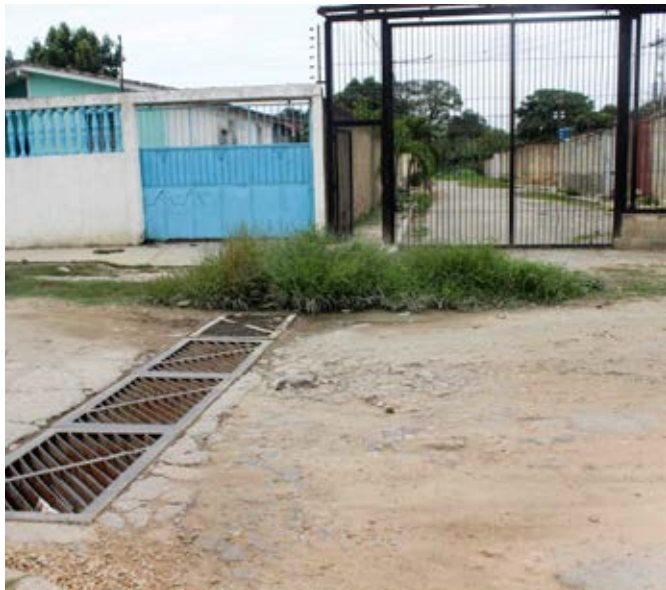
El deteriorado estado de la vialidad dificulta el libre tránsito
