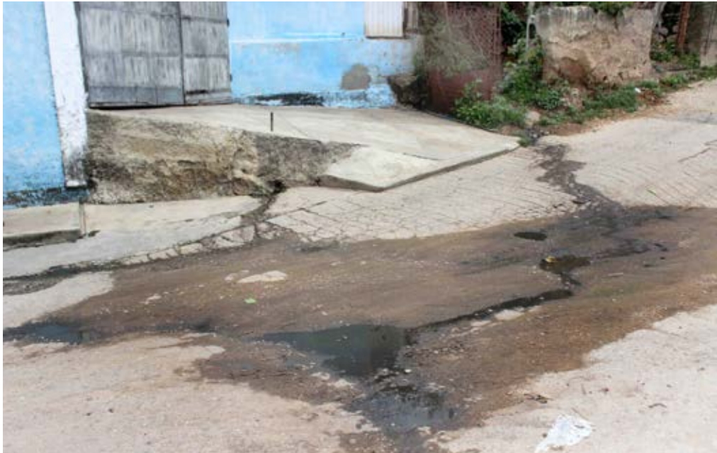
Las aguas servidas afectan el buen vivir vecinal
