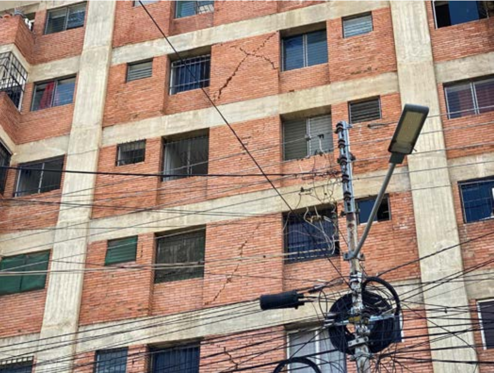
La estructura fue visiblemente afectada
