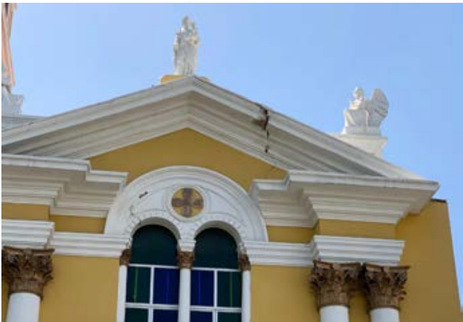
La fachada resultó afectada tras los sismos
