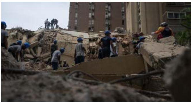
El edificio Petunia colapsó durante el doblete sísmico
