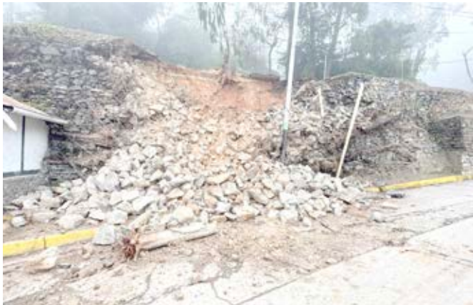
Los derrumbes afectaron el sector La Ballesta
