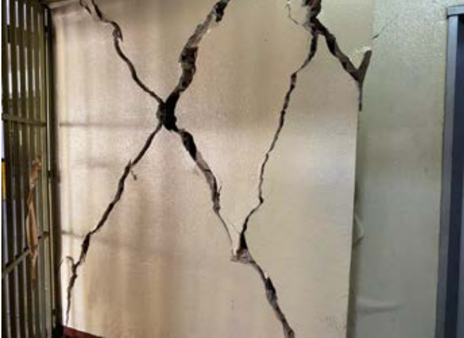
Las edificaciones sufrieron daños importantes
