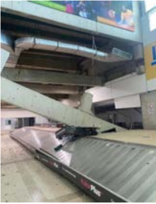
Una viga de concreto se desplomó sobre la cinta trasportadora de equipaje
