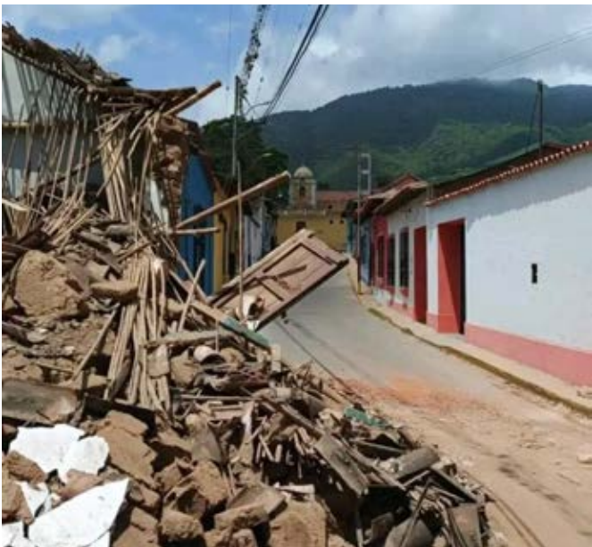
Choroní también se vio afectada por el terremoto
