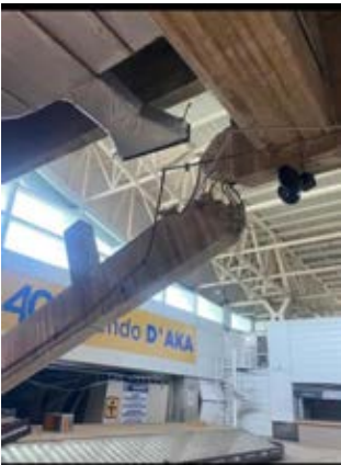
Daños severos estructurales en el área de equipaje dejó el doble terremoto del 24 de junio
