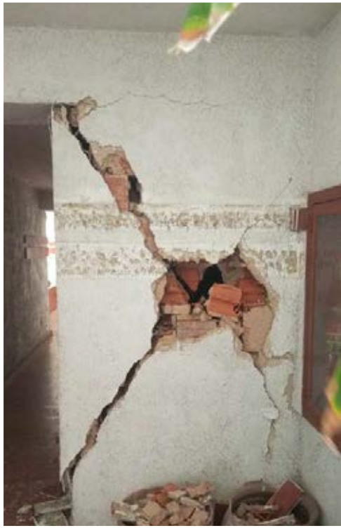
La infraestructura resultó afectada severamente
