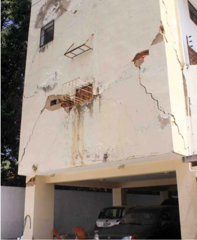
La estructura sufrió graves daños
