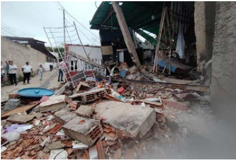
Ruinas de una casa de San Mateo, donde presumiblemente falleció una mujer
