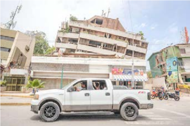
Varias edificaciones colapsaron desde sus estructuras
