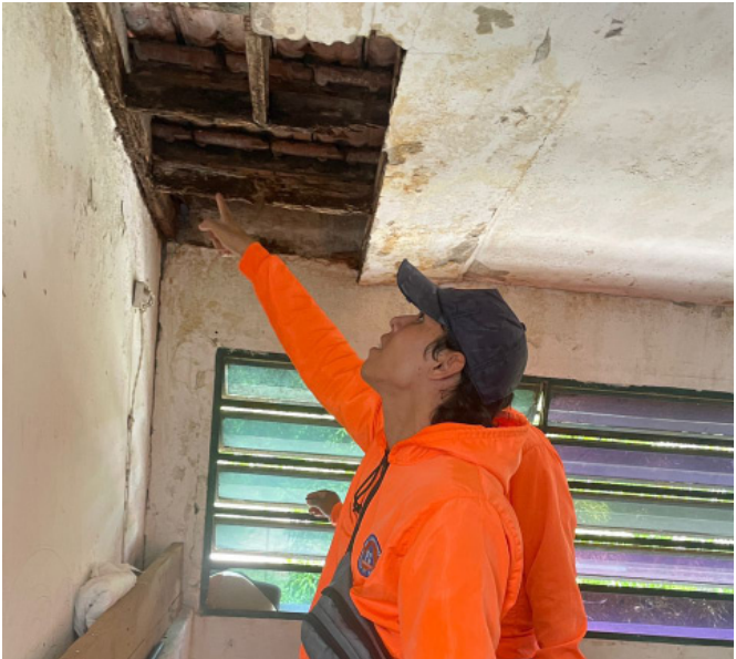
Inspección en áreas que presentaron daños
