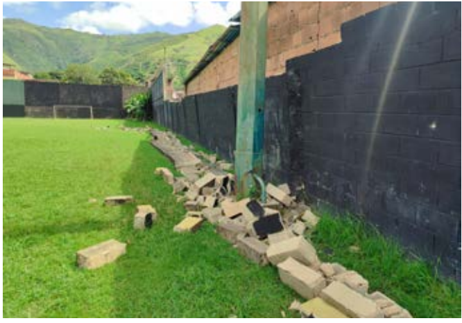
Varias paredes fueron derribadas por el sismo
