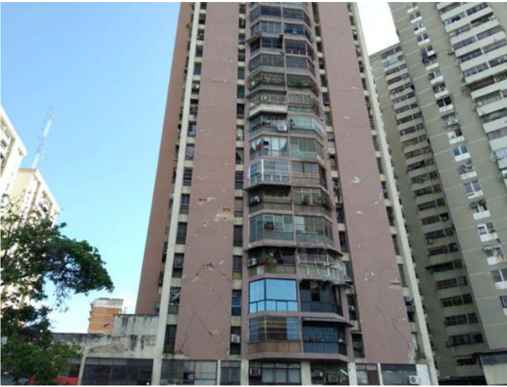
Residencias Los Mangos resultó con severas afectaciones
