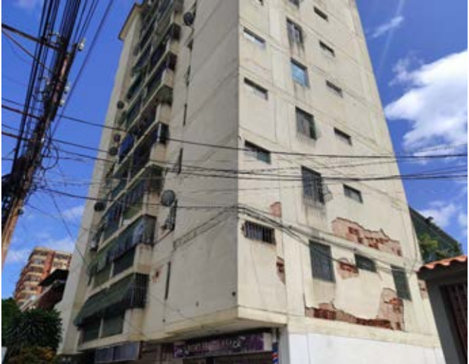
Hubo colapso de pocas infraestructuras
