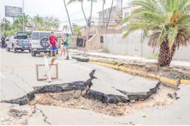
La capa asfáltica cedió al intenso movimiento telúrico
