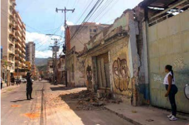
El muro de ladrillos está peligrosamente inclinado y a punto de caer
