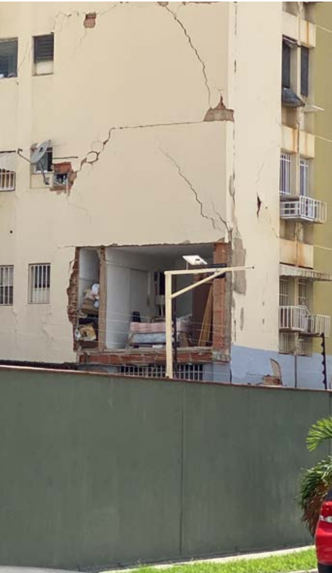
Edificios sufrieron importantes daños en infraestructura
