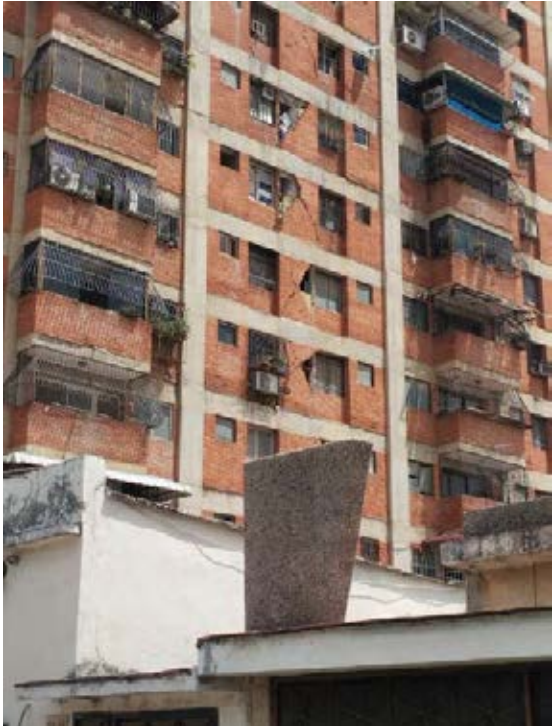
Las grietas son visibles
