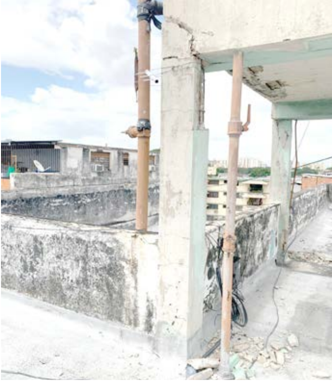
Dos de las columnas están desprendidas
