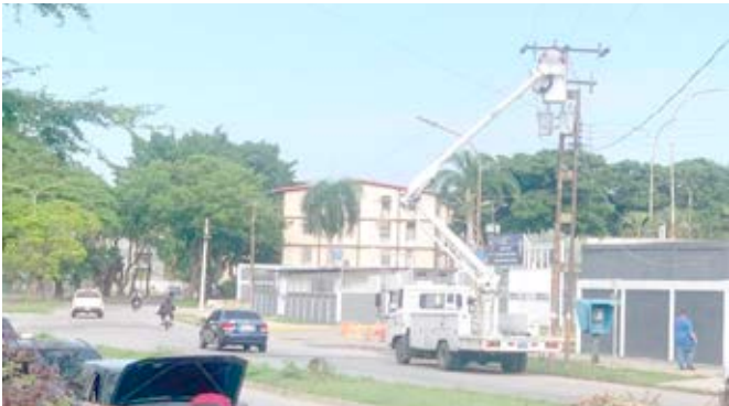
La falla afectó al sector 9 de Caña de Azúcar
