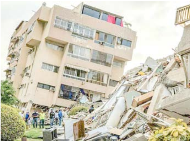
El trabajo está orientado a las estructuras que sufrieron daños graves
