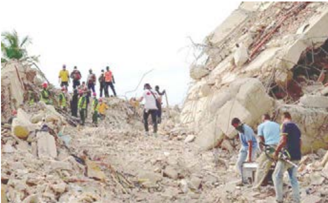
Parte de la edificación colapsada
