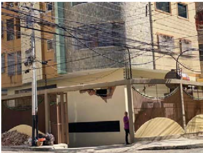
Hubo daño en la mampostería
