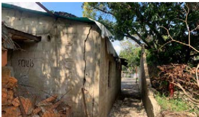
Una vivienda de La Cooperativa sufrió daños
