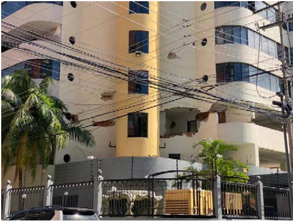
Varios edificios afectados por la eventualidad sísmica
