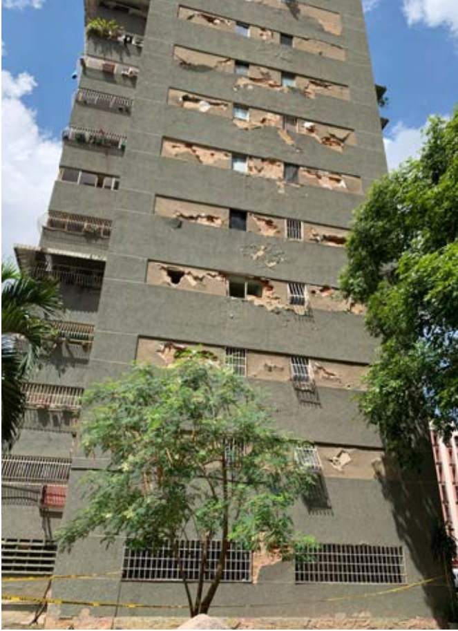
Paredes laterales de la torre sufrieron severos daños
