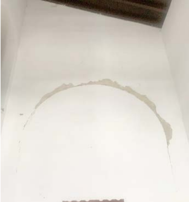
Parte alta de la fachada presenta grietas
