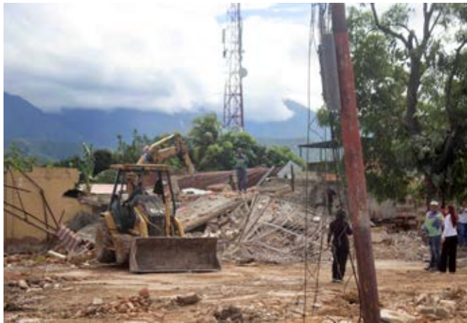
Maquinaria pesada tras el colapso de la edificación
