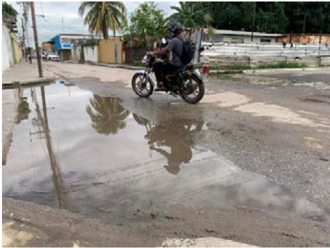
El tránsito vehicular se ve afectado
