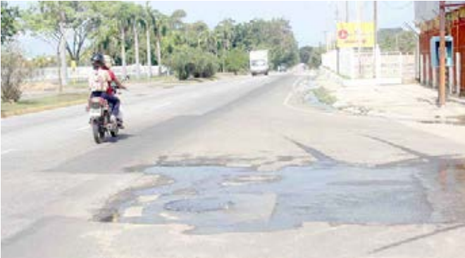
La alcantarilla colapsada de agua contaminada
