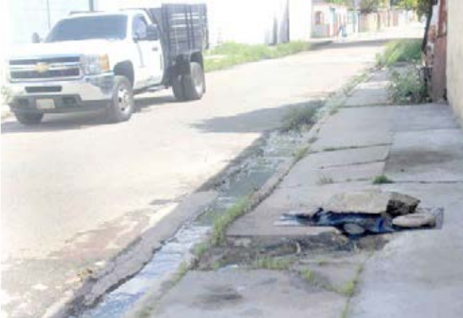
Uno de los cachimbos dañados en la calle Diego Ibarra
