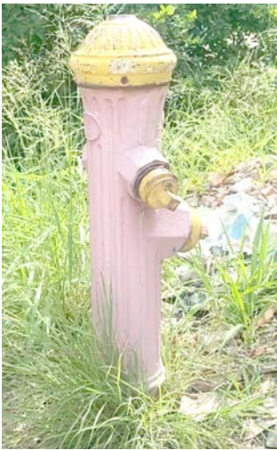
El hidrante resultó afectado tras los sismos
