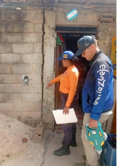
Dos locales sufrieron daños irreparables en Bahía de Cata
