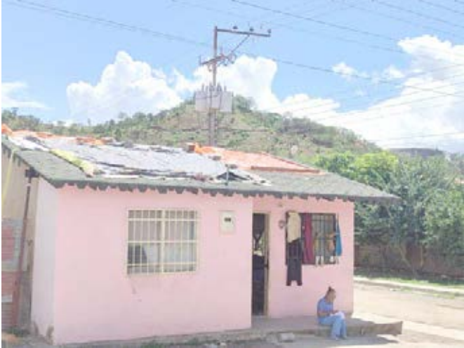
El techo de la vivienda se encuentra en pésimas condiciones
