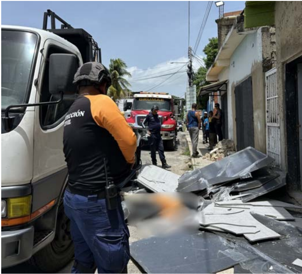
Un trabajador perdido la vida al quedar bajo las láminas
