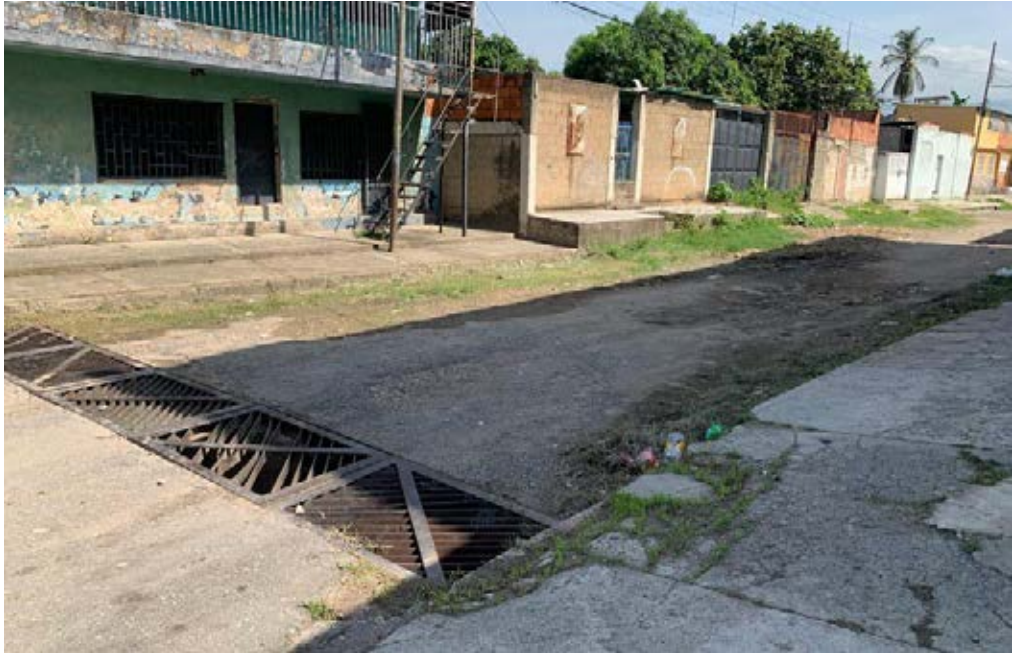
Los colectores se encuentran tapados y la calle no tiene asfalto
