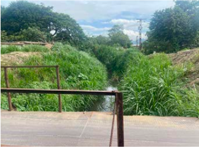
El óxido está destruyendo la infraestructura
