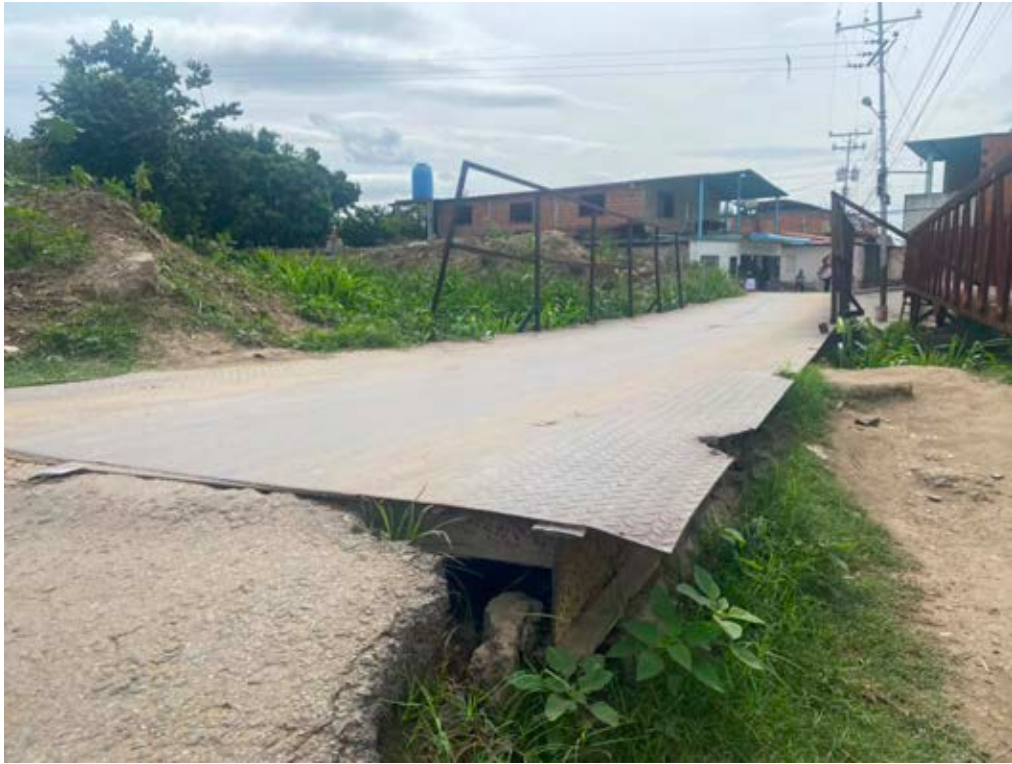
Un desnivel peligroso
