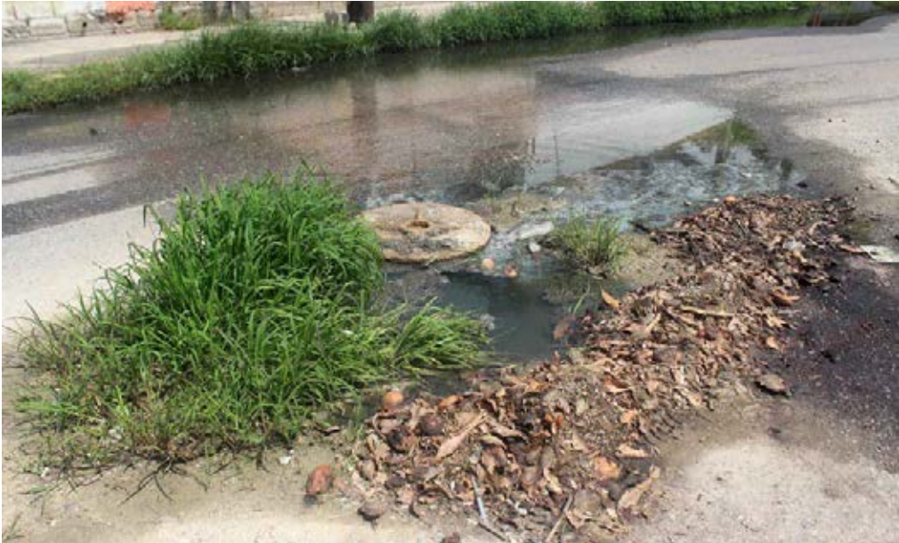
El sistema de drenaje colapsó
