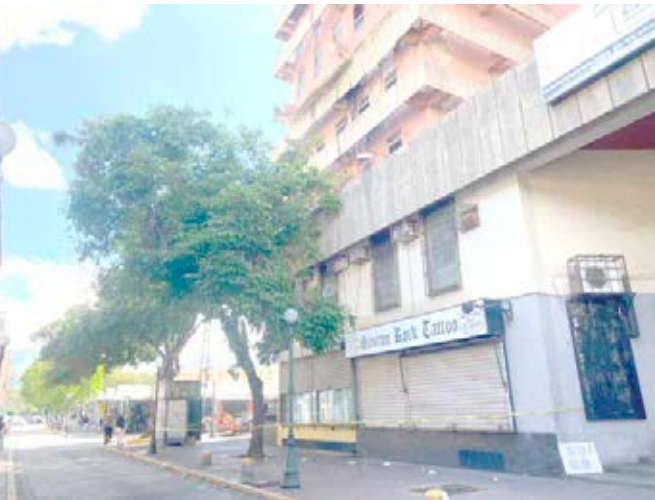
Los transeúntes temen un desplome de la estructura
