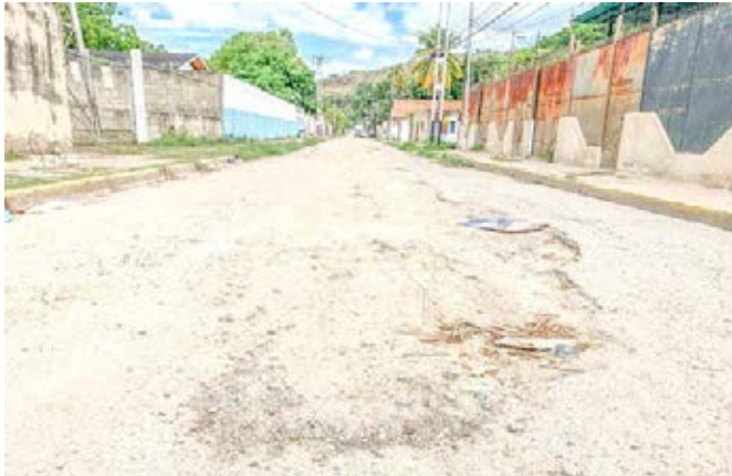
Las calles se encuentran intransitables
