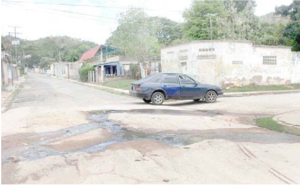
Las cloacas se desbordaron en la calle Sucre con Carabobo
