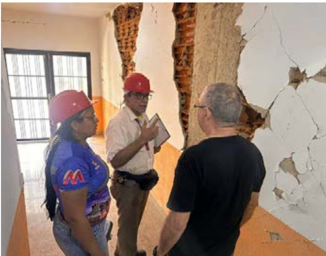
Los daños fueron principalmente en mampostería
