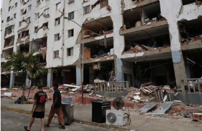
Las autoridades evalúan los daños causados en la infraestructura habitacional
